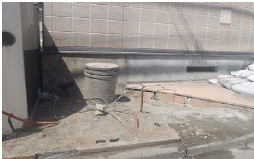
写真 7 液状化により浮上した柵
