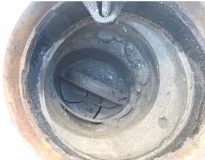
写真 8 柵内に堆積した土砂
