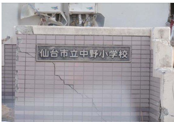
地震により門扉に亀裂が入っている。
