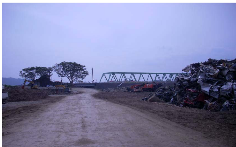
新北上大橋付近の瓦礫の除去作業中（右には壊れた車両の山）
