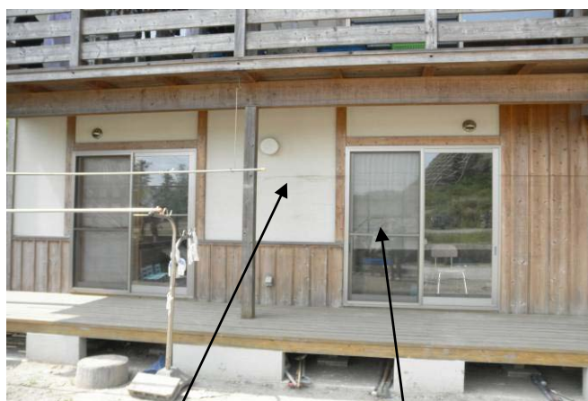
津波が押し寄せた跡 ビニールシート
