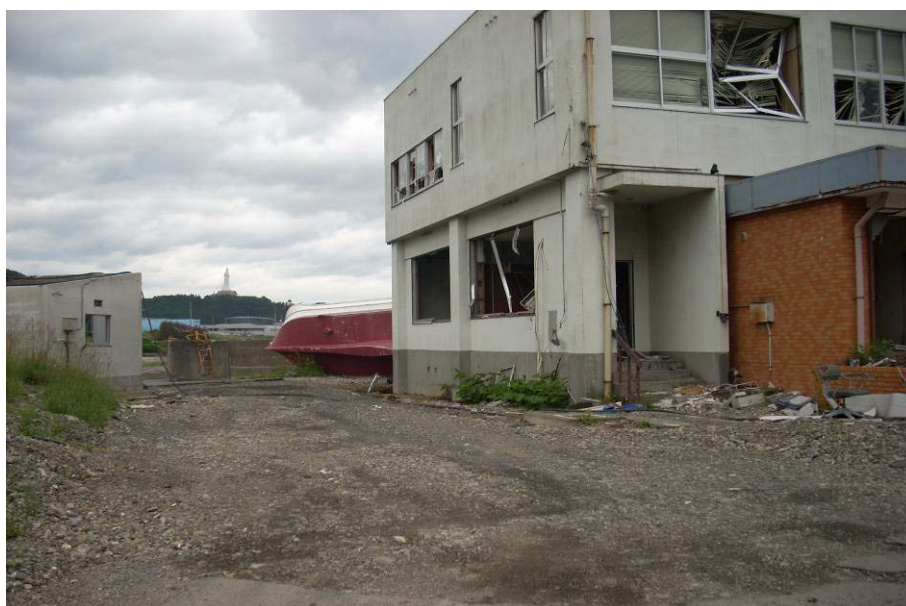
津波で損壊した釜石市漁業協同組合の建物：遠くに「釜石大観音像（48.5m）」
