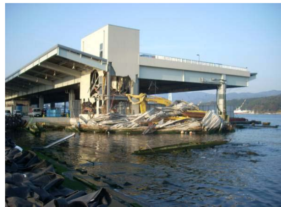
冠水している魚市場
