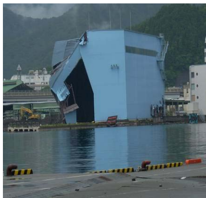
(新日本製鐵(株)釜石製鉄所の倒壊した荷揚所)
