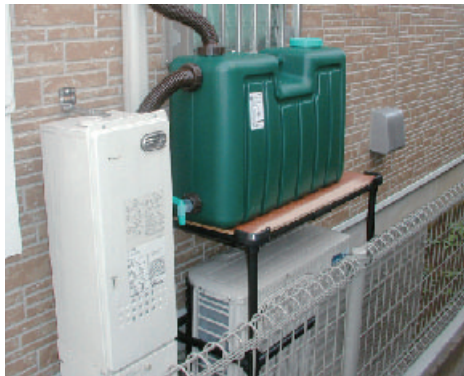
雨水貯留槽 設置例：田中町S様 (100ℓ)
