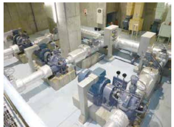
（東部配水場の配水ポンプ）
