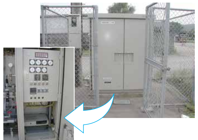
水質監視路上局の外観と内部の検査計器
