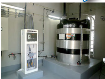
次亜塩素酸ナトリウムの貯留タンクと注入機
