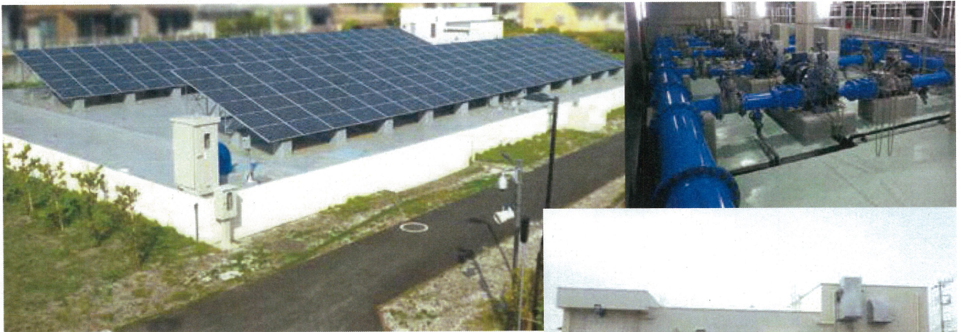
(更新工事を完了した西部配水場の様子) 上は配水池とソーラーパネル 右上はポンプ設備、右下はポンプ棟外観
