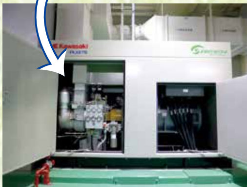
発電機室（上）と発電機（下）
