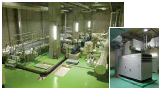
写真はポンプ室(上)と発電機(右)
